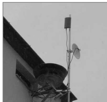
Anténa místní internetové sítě na věži požární zbrojnice.
